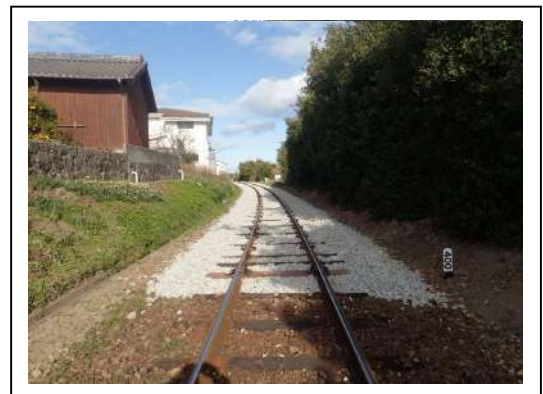
有明湯江駅～大三東駅間 レール交換・マクラギ交換 （施工後）
