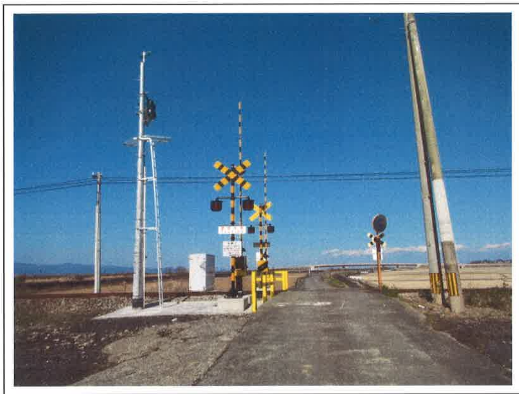
諫早東高校前駅～愛野駅間 第59号踏切道 視認性向上のため、LED全方向型警報灯を採用しています。
