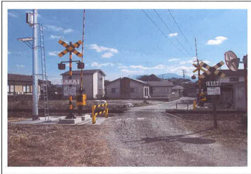
古部駅構内 第84号踏切道 視認性向上のため、LED全方向型警報灯を採用しています。
